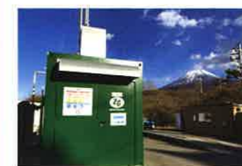
メタンガス発電機
